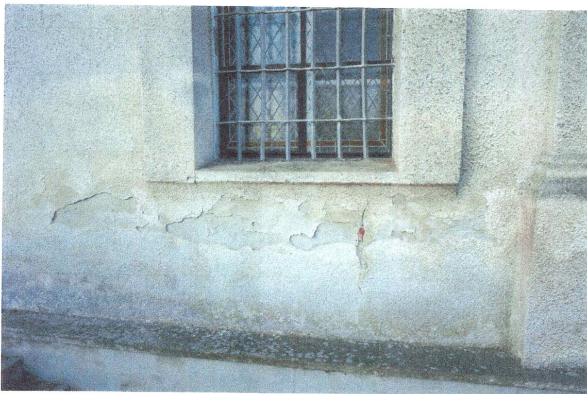
Fot. nr 12 Wysolenia na ścianie zewnętrznej
