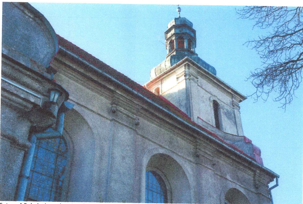
Fot. nr 4 Pęknięcie nadproża, elewacja w złym stanie
