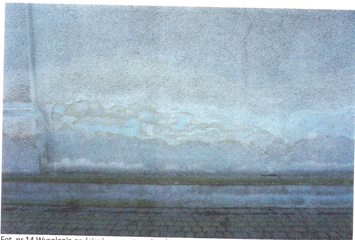
Fot. nr 14 Wysolenia na ścianie zewnętrznej, pęknięcie ściany
