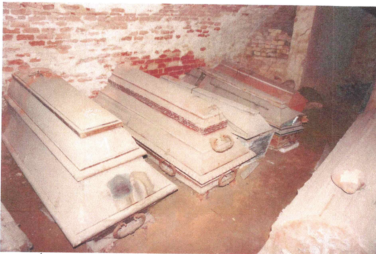
Fot. nr 11 Ślady zawilgocenia i widoczne wysolenia na ścianach krypty
